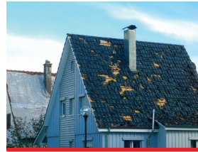
Dächer nach einem Hagelschlag
